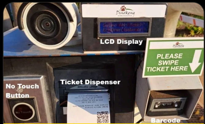
El poste de la puerta: pantalla LCD de 2 líneas, pulsador No Touch, dispensador con un ticket QR y escáner de códigos de barras.
