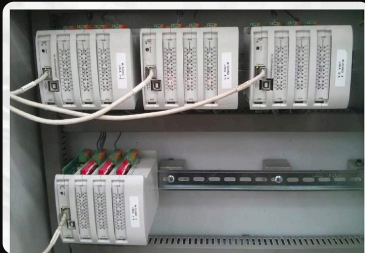
Dentro del armario de Fortaps: cuatro PLC M-Duino, cada uno con la etiqueta de dos líneas (1-2, 3-4, 5-6, 7-8) y su cable Ethernet.
