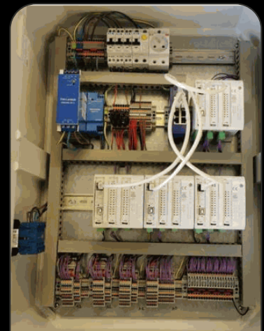
El armario de control con los PLC de Industrial Shields. © Frédéric Gazeau
